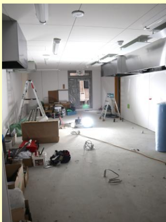
給食室には換気扇が設置 されました。
